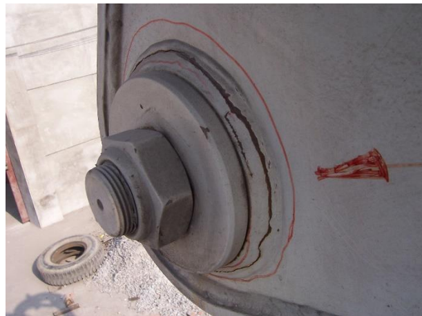
Elemento braccio Cricca in zona fusa Materiale boccola S355 J2 Materiale lamiera S700 MC
