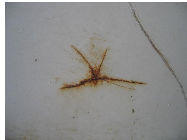
Elemento braccio Cricca originata da una saldatura interna con propagazione in varie direzioni. materiale: S690 QL
